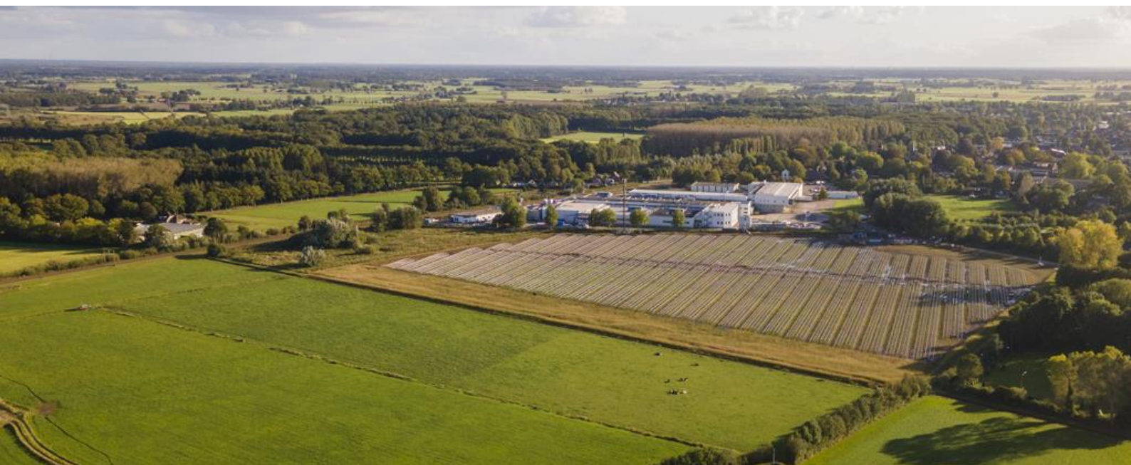
Foto: Het zonneveld van de toekomstige Energietuin in Wijhe in aanbouw. (Foto: Leander Broere)
