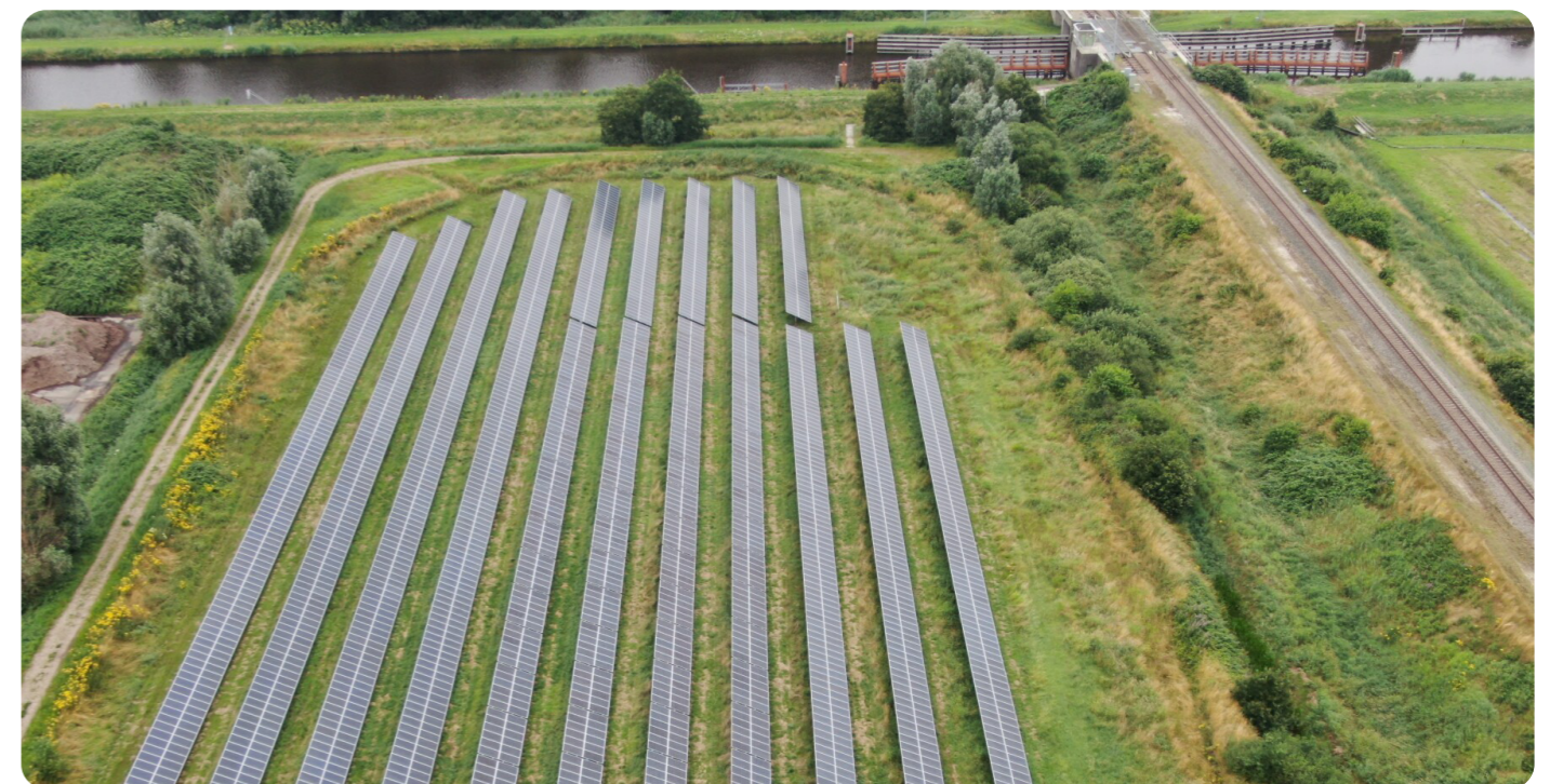
Zonnepanelenpark SunBrouck gebouwd op een voormalige crossbaan
