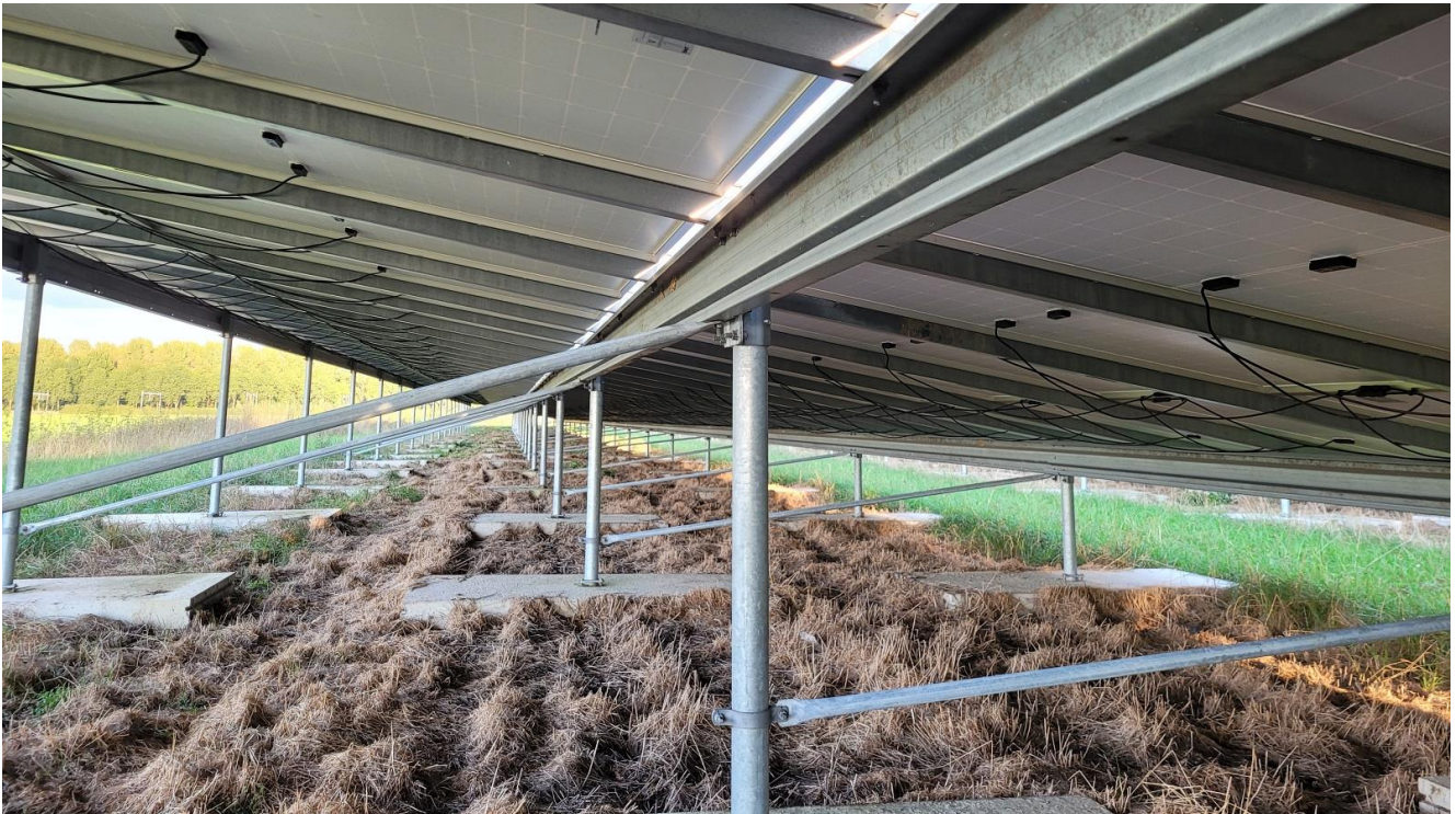
Afbeelding 1 - Verdord gras onder zonnepanelen door een gebrek aan licht en water. (Foto: Alex de Meijer)
